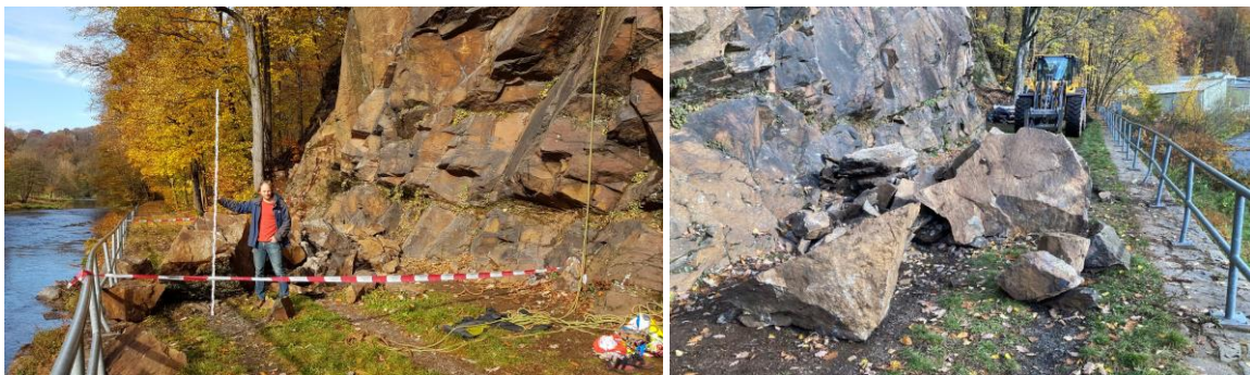
Sperrung der Abbruchstelle und Beräumung der Lockermassen mit schwerer Technik (Fotos: DAV-Landesverband und LfULG)
